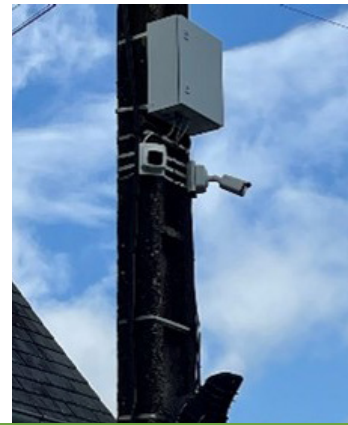
Pose de caméras de vidéosurveillance près du local poubelles
